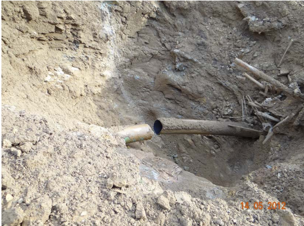
ROTURA DE TUBERÍA DE 20" POR ESFUERZOS DE TENSIÓN
