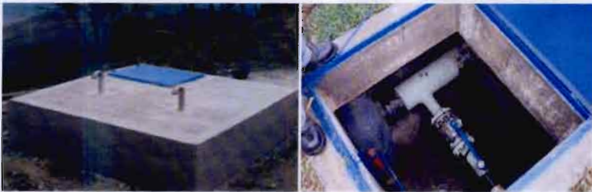
CAJAS DE INSPECCIÓN - UCCIN.
